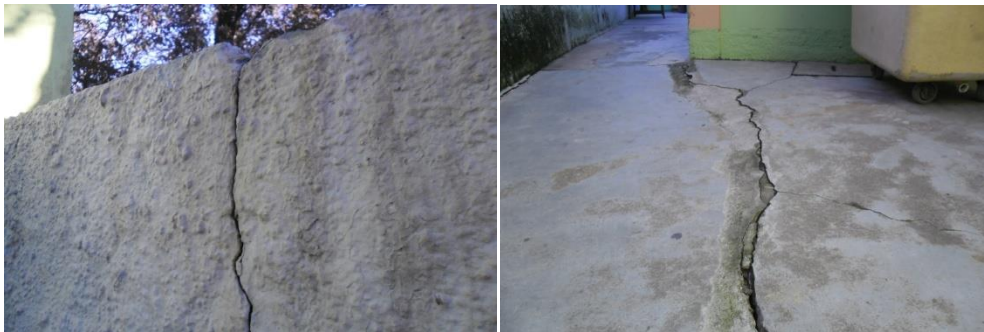
Figura 19 e 20. Rachaduras em muro e piso na PcB
