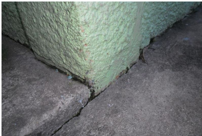
Figura 16. Rachaduras entre piso e parede na PcB.
